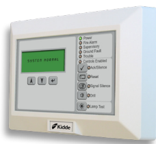
Se pueden configurar hasta 30 anunciadores de la serie R para cada panel de la red de la serie VM.
